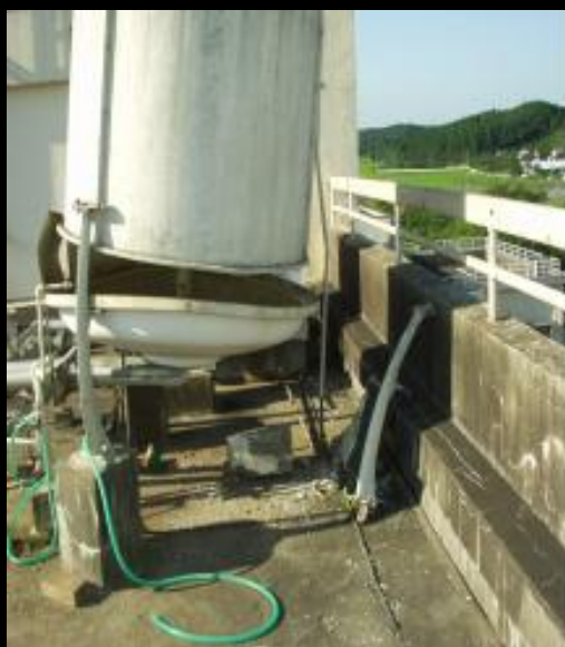
貯水槽が傾き水漏れ
